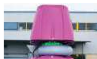
Ventilazione forzata ATEX
